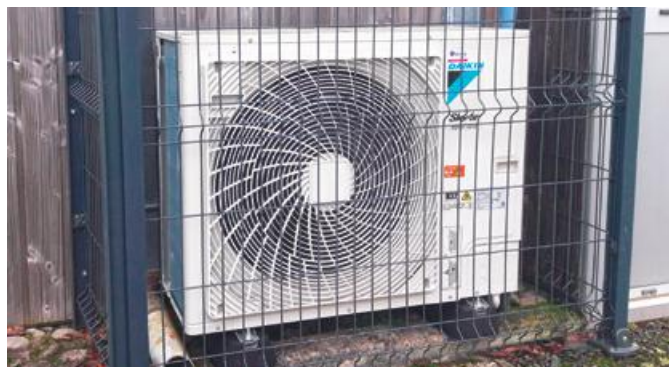
2 pompes à chaleur installées à la salle polyvalente
